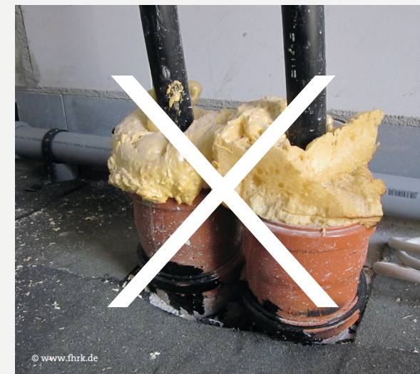
Abb. 3: Nicht gas- und wasserdichte Ausführung
